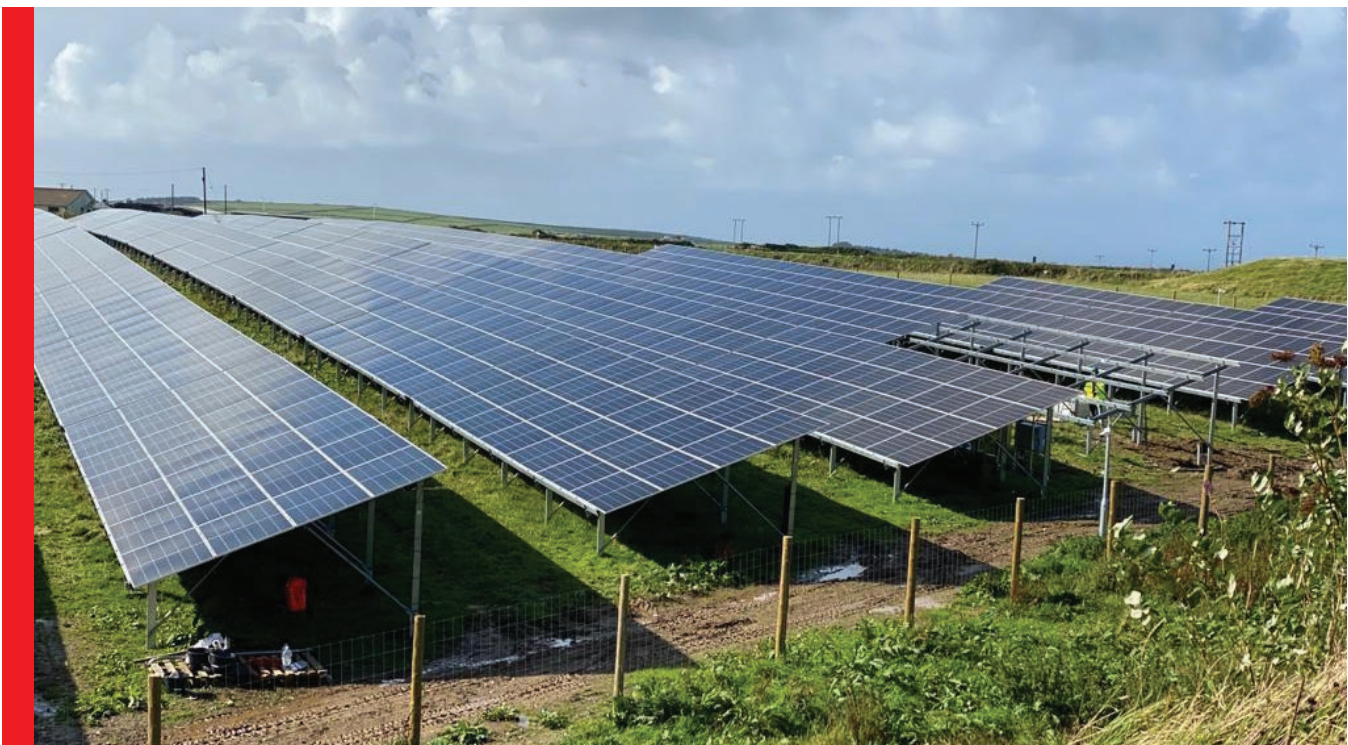
Panneaux solaires installés à l'usine Saputo de Davidstow au Royaume-Uni (photo fournie par Saputo)
