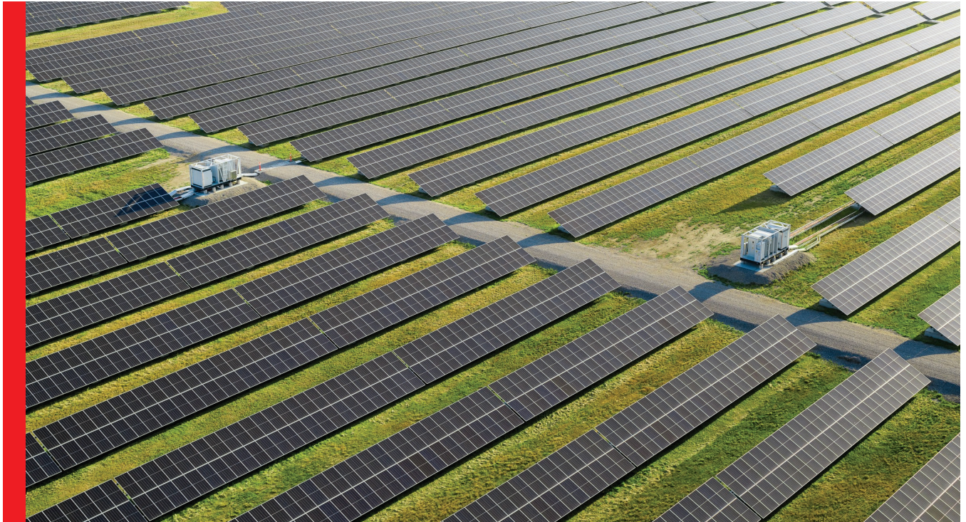
Les projets solaires de Deerfoot et de Barlow, apparentant conjointement aux Premières Nations Chiniki et Goodstone et d'ATCO, génèrent suffisamment d'électricité renouvelable pour alimenter 16 500 foyers (photo fournie par ATCO)
